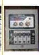
自動制御装置
