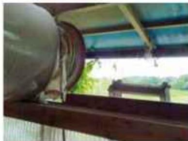
水田側に設置されたファン
