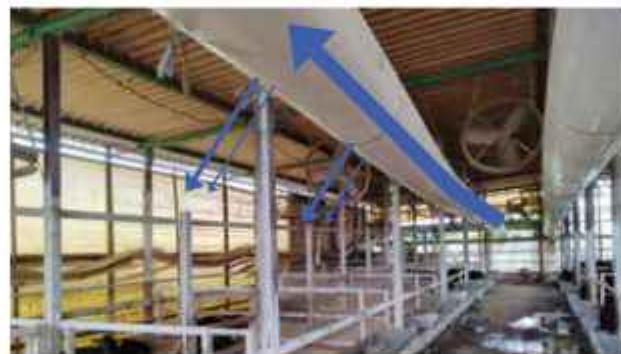
写真奥にファンが設置されておりそれぞれのパドックに空気が排出される。写真では通路に2本だが実際は壁際にも2本、合計4本のトンネルダクトが設置されている
